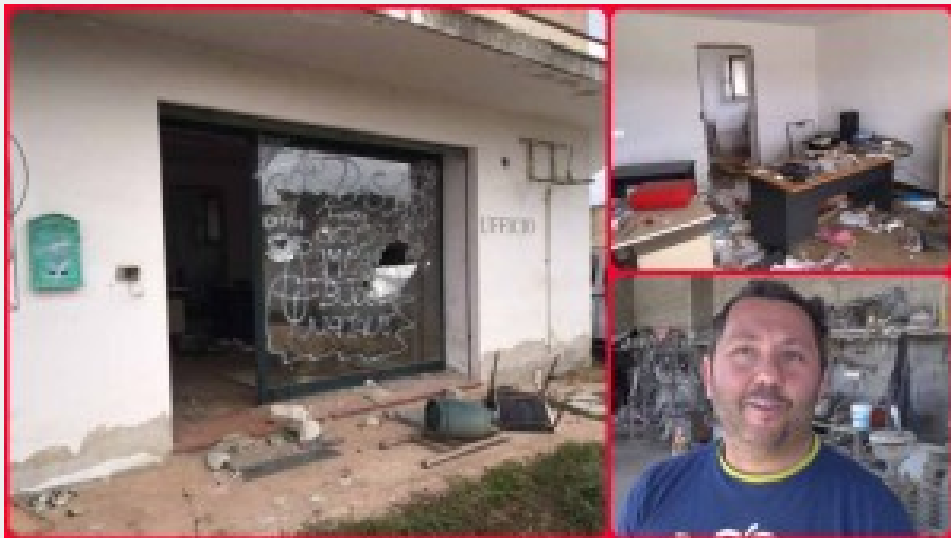
Ancora atti vandalici nell'azienda di Giuseppe Addis chiusa a giugno "per disperazione"
